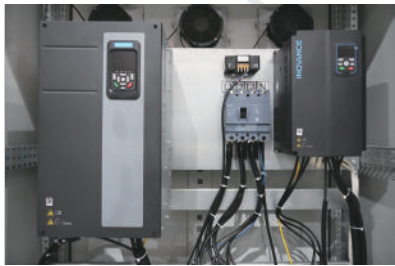
电气系统 Electrical System
