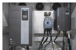
电气系统 Electrical System
